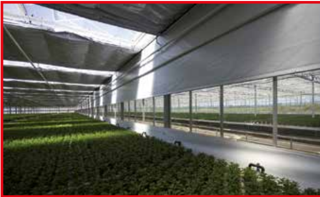
Verdunklungsanlage im Foliengewächshaus
